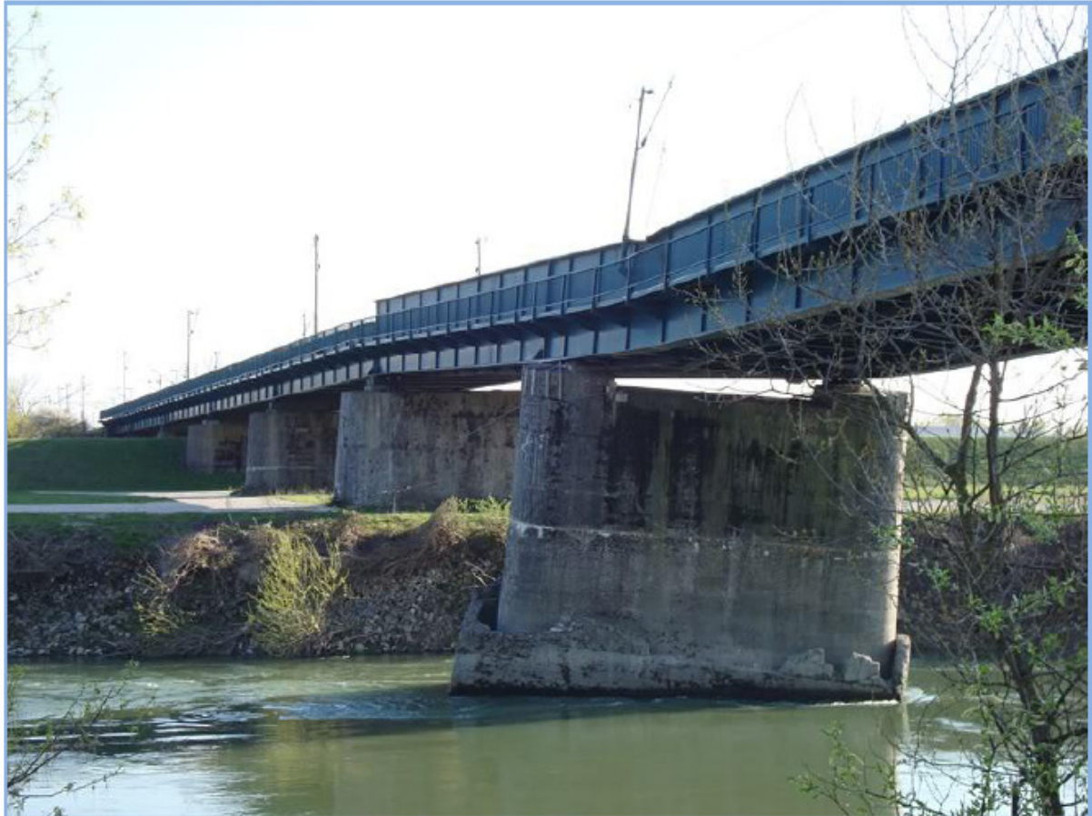
Slika 5: Slom stupa željezničkog mosta u rijeci Savi kod Žitnjaka
