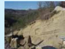
OSTACI KLIZIŠTA BRUS REMAINS OF BRUS LANDSLIDE SANJA DUGONJIĆ JOVANČEVIĆ, RIJEKA, CROATIA
